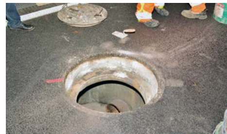
Die alte Abdeckung wurde entfernt und der Schacht wurde für den Einsatz der neuen ACO Schachtabdeckung Multitop vorbereitet
