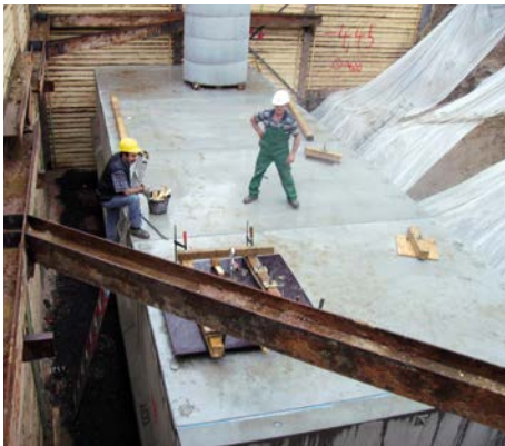
Einbaubeispiel: Löschwasserbehälter 100.000 l, Universität Mainz
