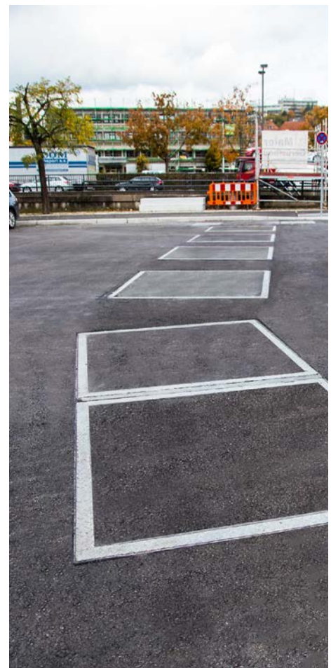
Rückstausichere Abdeckungen mit Asphaltfüllung, Ansbach
