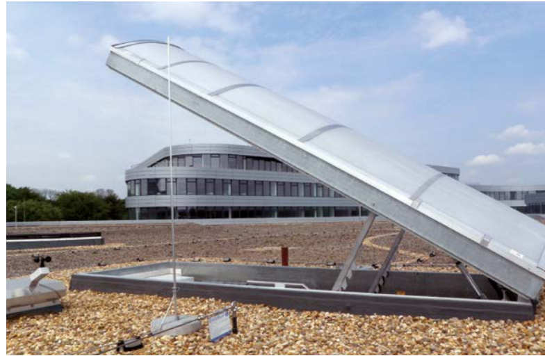
Hydraulisch betriebener Dachausgang und RWA-Klappe, Köln
