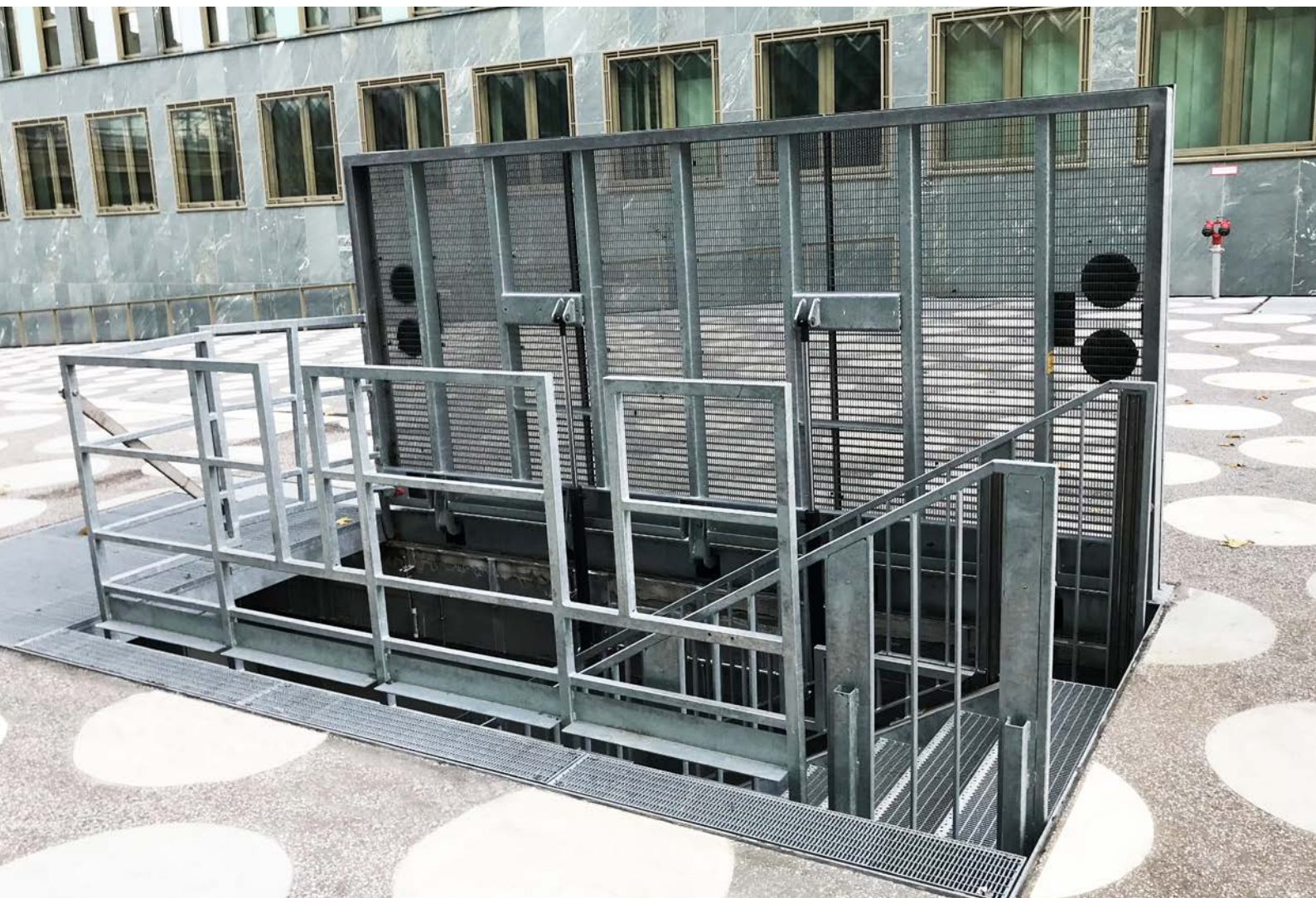
Bodentor und Notausstieg am Berliner Zukunftsmuseum Futurium in unmittelbarer Nachbarschaft von Reichstag und Hauptbahnhof: Innerhalb von 25 Sekunden ist die Fluchttreppe inklusive Handlauf vollständig ausgefahren und begehbar
