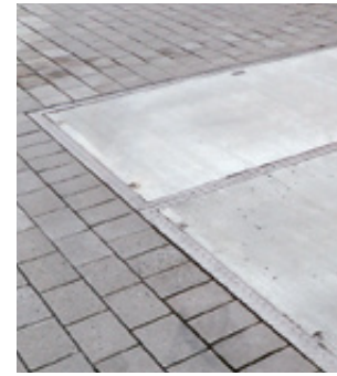
Kleine und handliche bzw. selten zu öffnende Schachtab- deckungen ohne Öffnungshilfe
