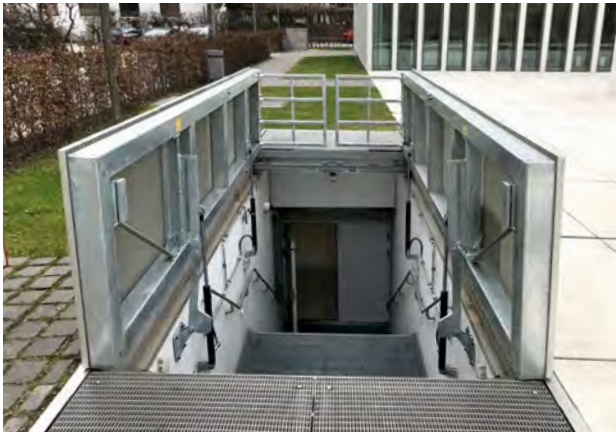
Notausstieg mit ausgepflastertem Deckel, Frankfurt
