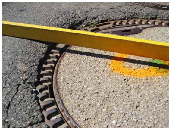
Durch schadhafte Unterbau abgesunkene Schachtabdeckung
