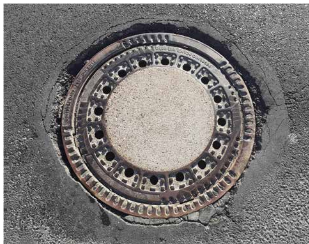
Frostaufbrüche rund um Schachtabdeckungen lassen sich vermeiden © Foto: GET
