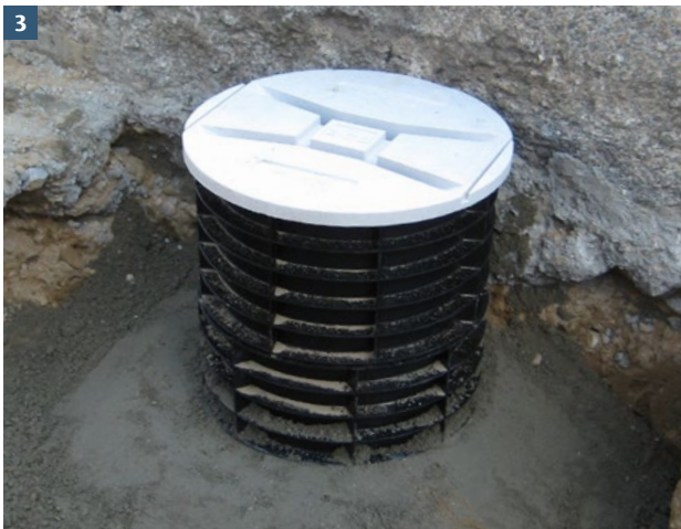
3 Unterteil auf Fundamentbeton C 12/15 versetzt und bis zur ersten Querrippe mit Rückstütze einbauen.
