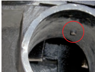
Negativbeispiel 1 Ablauf mit Schraube in der Rohrleitung ermöglicht keine vollständige Abdichtung
