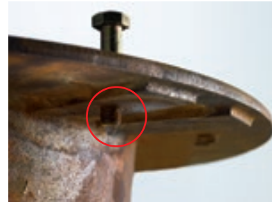
Negativbeispiel 2 Aufgrund der durch den Flansch gehenden Schraube ist eine sichere, dauerhafte Abdichtung nicht möglich
